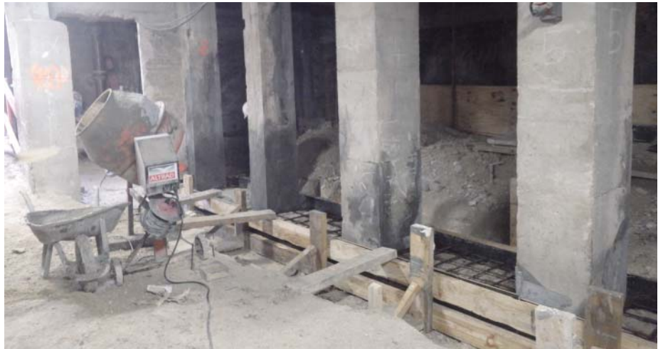
{ Lors de la 1 ère phase des travaux, l'infrastructure du bâtiment a été consolidée : enlèvement des terres polluées, purge des bétons, vérification des armures... }
