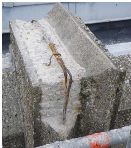
{ Les façades de l'église qui ont subi un phénomène de carbonatation* du béton, sont en cours de traitement. }
