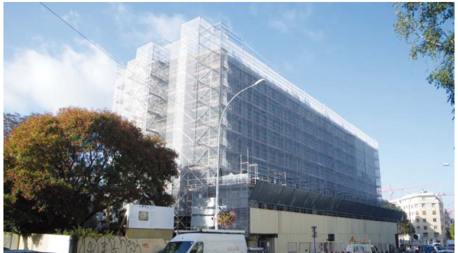
{ Les échafaudages recouvrent l'église Saint-Jacques située au pied de la station Mairie de Montrouge : c'est le début de la 2 ème phase des travaux de consolidation de la superstructure. }
